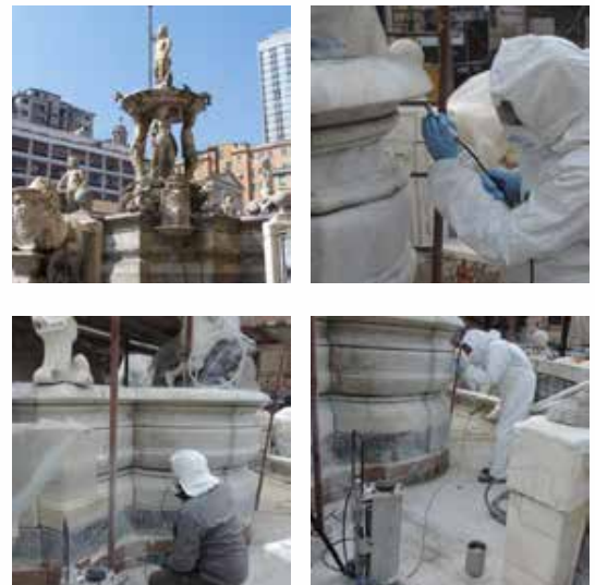
Fontaine de Neptune (1595) - enlèvement des incrustations calcaires avec carbonate de calcium et vaporisation d'eau.
