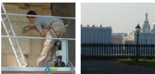
Porte de Pierre (1714) - Nettoyage de la pierre de kikierno - dolomite, élimination enduit et stuc. Nettoyage/sablage des nouvelles pierres de substitution.
